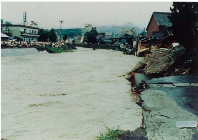
写真 1.2.3 肝属川 18k200*付近 （朝日橋上流左岸）被害状況
